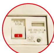
漏電遮断器 (主幹ブレーカー)
